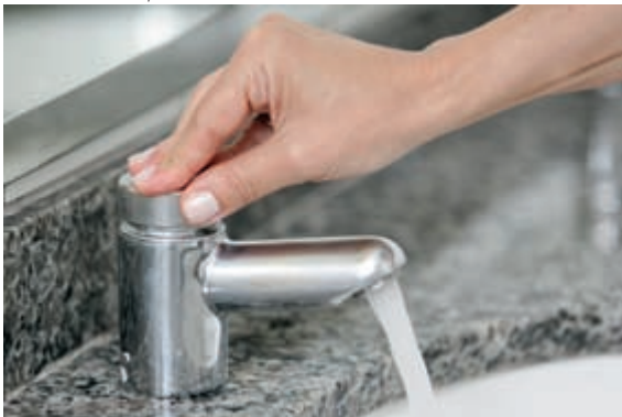
FIGURA 34 —TORNEIRA COM FECHAMENTO AUTOMÁTICO: ECONOMIA DE ÁGUA.
