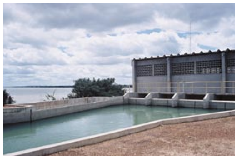
Estação de bombeamento do Projeto Pontal: um exemplo de captação de água no rio São Francisco.
